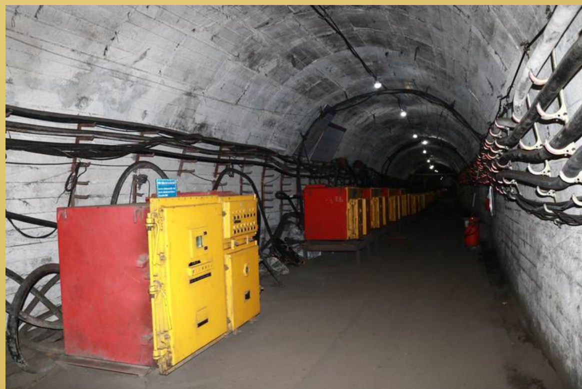
Hệ thống trạm điện, hầm bơm các mỏ hầm lò được duy trì đảm bảo bơm thoát nước, thông gió
